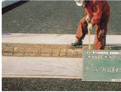
▲バックアップ設置状況
