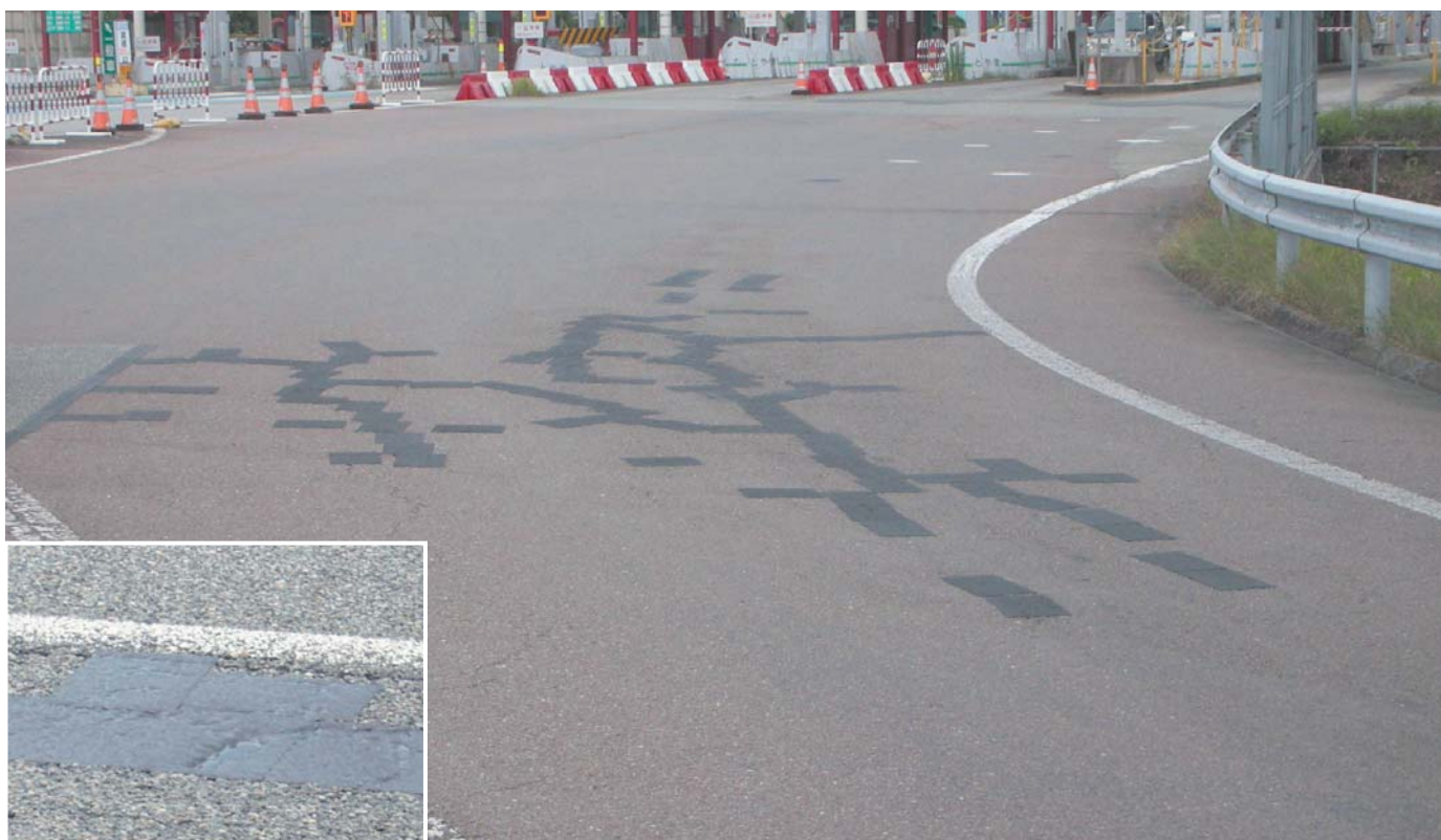
クラックへのなじみ状況
